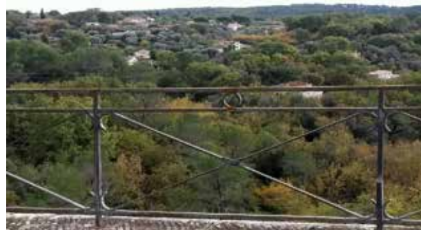
Garde-corps d'origine non conforme
