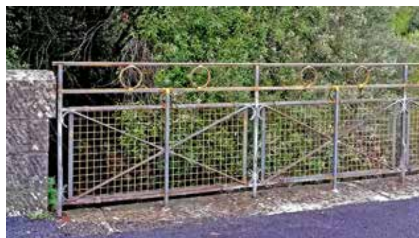
Garde-corps modifié : hauteur et ouverture
